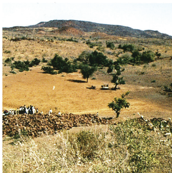
Première étape: le village se met au travail sur le site du barrage après avoir ramassé des pierres
